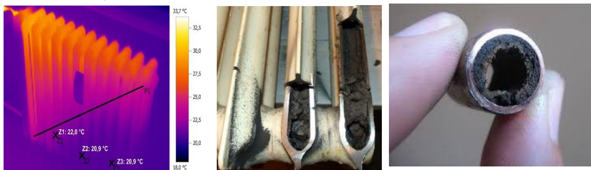
Obrázek 7: Přínosy chemického čištění rozvodů
